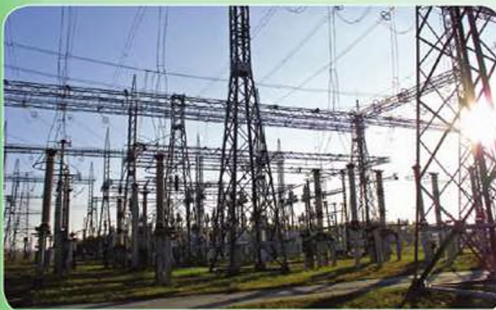
محطة توليد كهرباء شمال القاهرة
