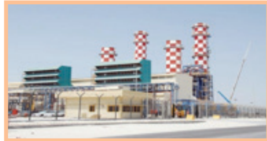
مستند رقم ٣: محطة كهرباء
