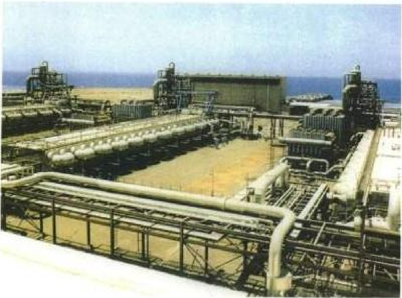
شكل رقم (٢٥) محطة تحلية مياه البحر
