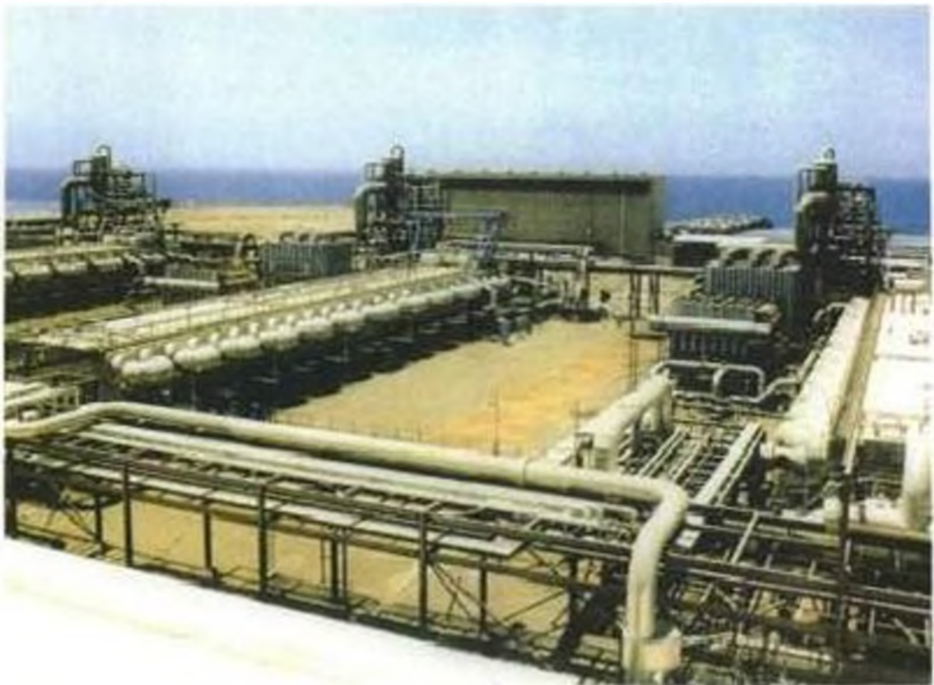
شكل رقم (٢٥) محطة تحلية مياه البحر
