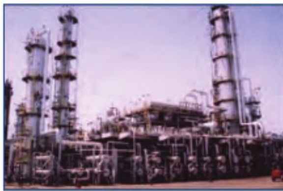
الصورة ٨ / ١ مصفاة النفط حمص
