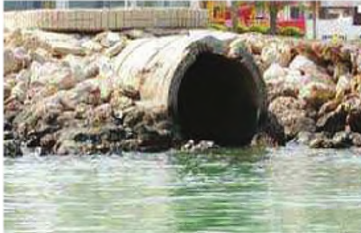
الصورة (٨) تلوث البحر بمياه الصرف الصحي في الساحل السوري
