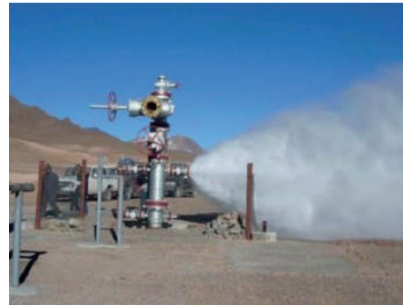
Planta geotérmica de Laguna Colorada, Potosí
