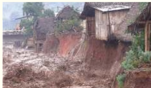
Viviendas en riesgo en la Costa ecuatoriana
