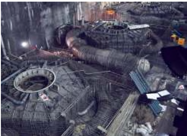
Proyecto Sopladora, con una inversión de USD 755 millones, generará 487 MW de potencia
