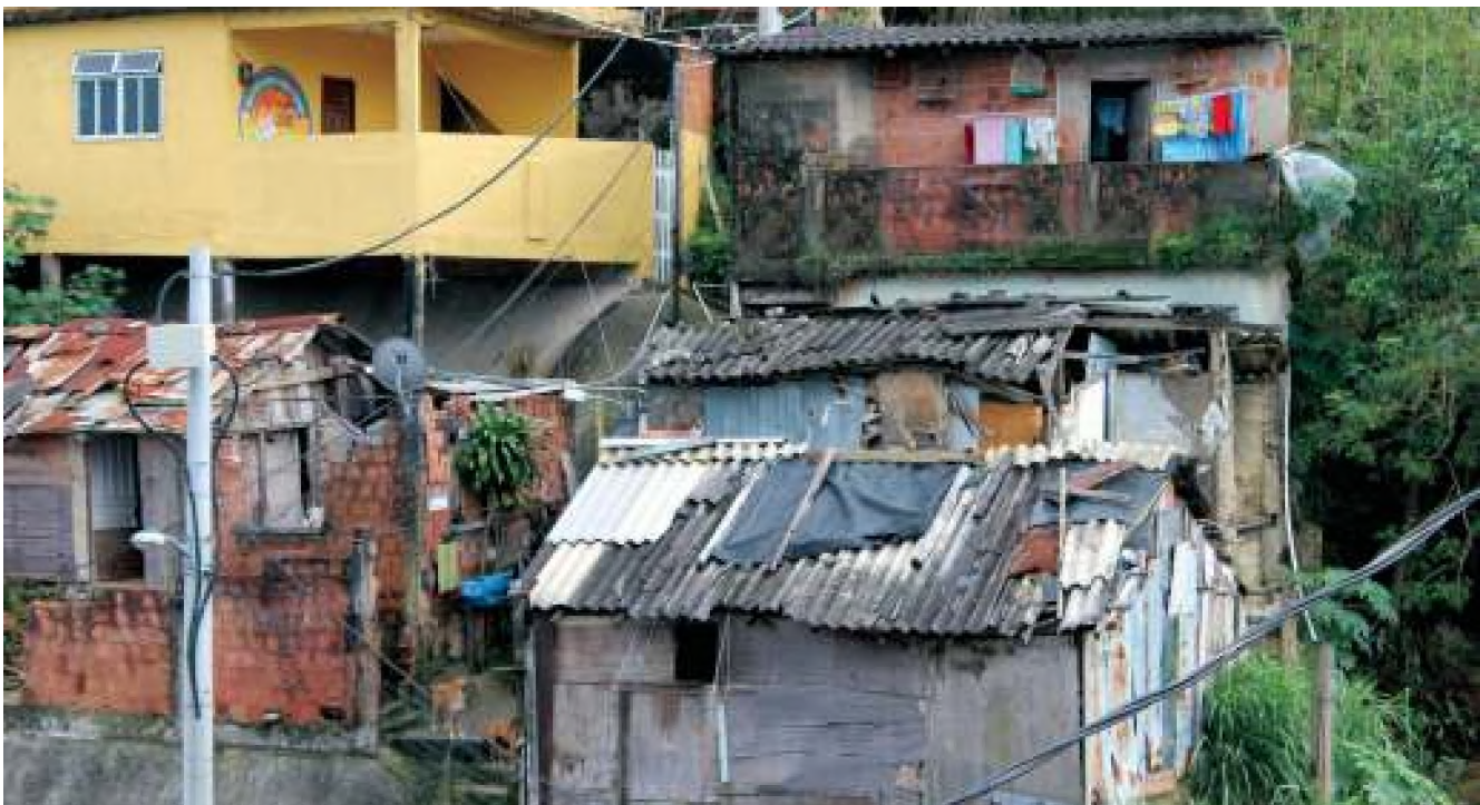
El deterioro o la baja calidad de construcción de las viviendas es una muestra del empobrecimiento de amplios sectores sociales en el Ecuador y América Latina
