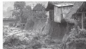
Viviendas en riesgo en la Costa ecuatoriana. Foto: Raúl Yáñez
