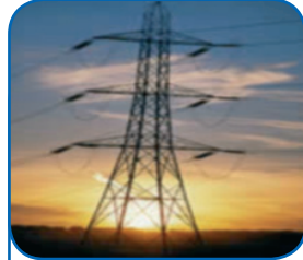
انقطاع الأسلاك الكهربائية
