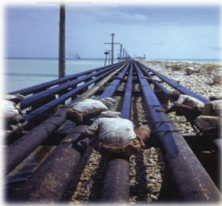
الصورة (١٢) أنابيب نقل النفط
