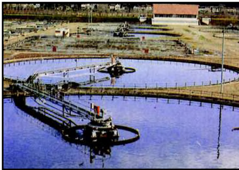
شكل (٥) محطة معالجة مياه الصرف الصحي
