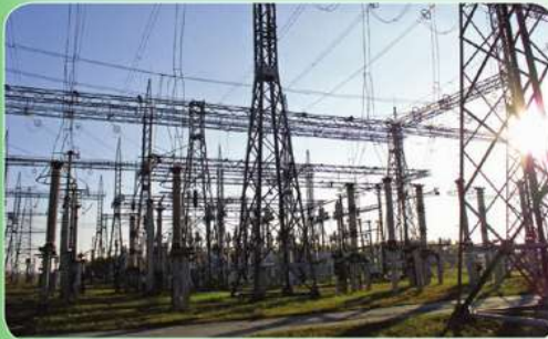
محطة توليد كهرباء شمال القاهرة
