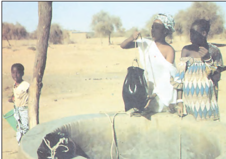
(٤) صيانة جوانب بئر قديمة في السنغال وحمايتها من الانهيار. هذه من الأعمال التي يقوم بها متطوعون للحفاظ على موارد المياه.
